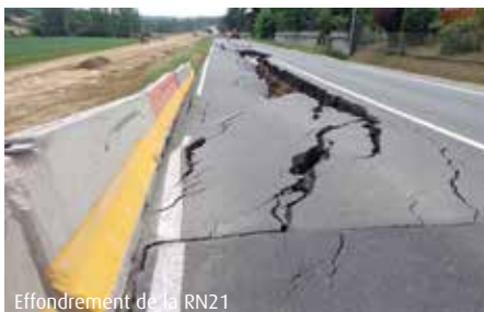
Effondrement de la RN21
