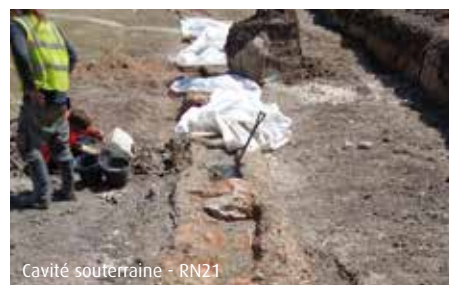
Cavité souterraine - RN21
