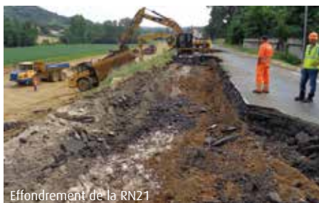
Effondrement de la RN21
